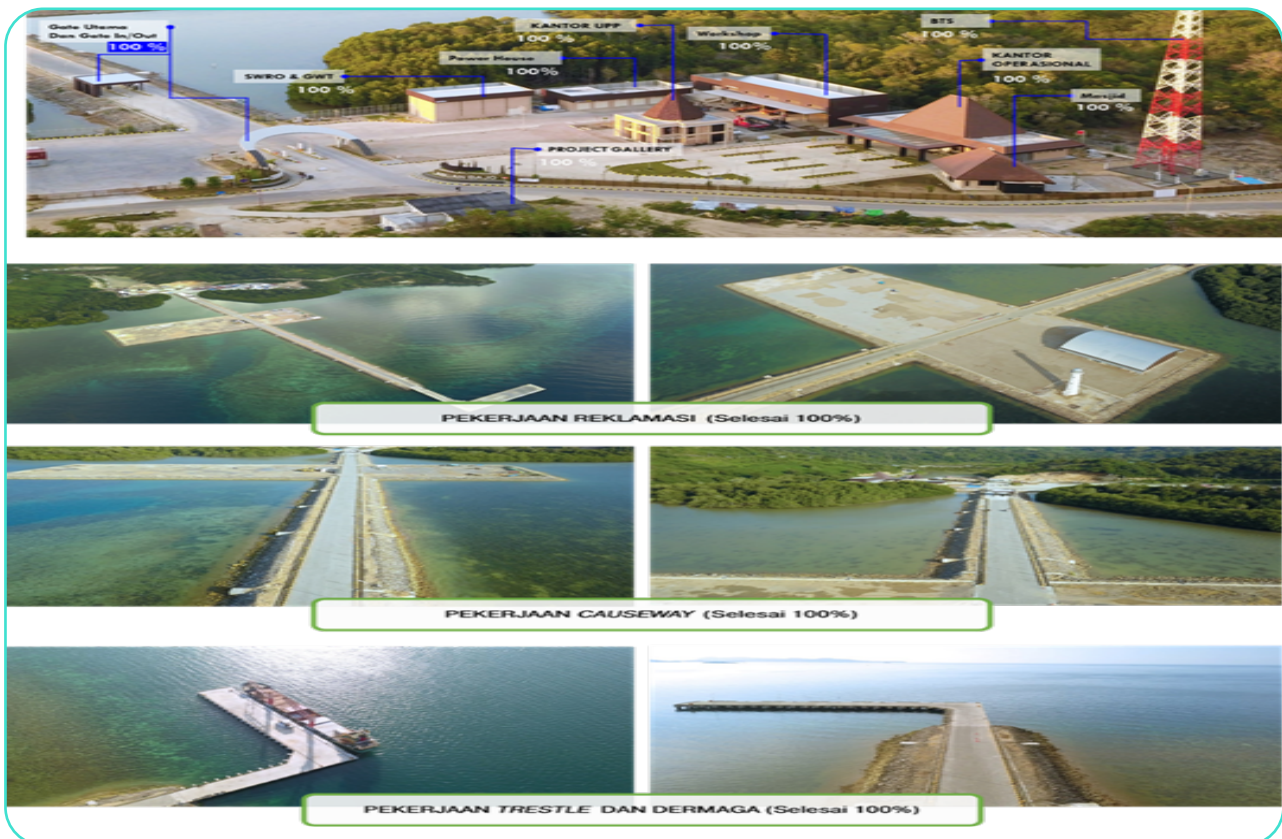
Gambar Dokumentasi Pembangunan Terminal Multipurpose Labuan Bajo Construction of the Labuan Bajo Multipurpose Terminal Documentation
