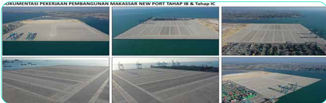
Gambar Dokumentasi Progres Pembangunan Makassar New Port Tahap 1B dan 1C Progress Construction of Makassar New Port Phase 1B and 1C Documentation
